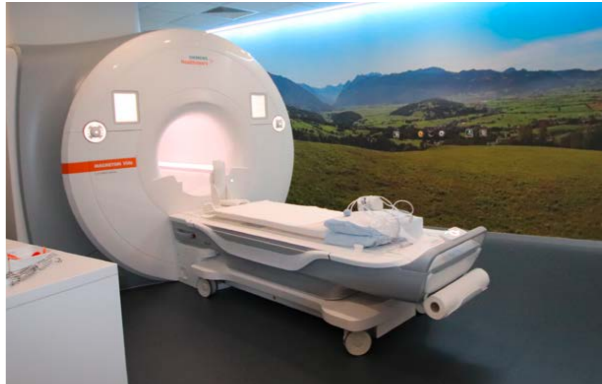
Die neue MRI-Anlage
